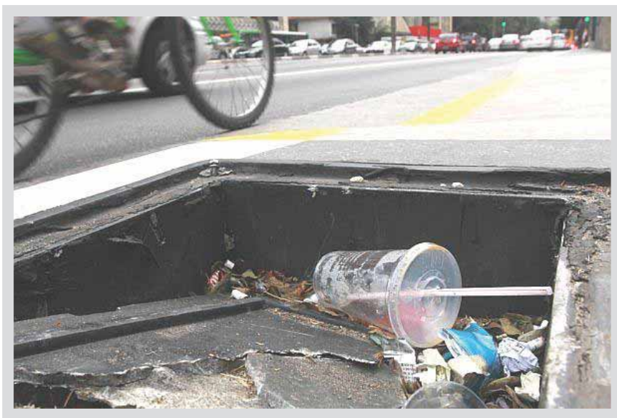
FOTO 10.4.8-5 – ESTADO DE MANUTENÇÃO DEFICIENTE DE ALGUMAS CALÇADAS (AV. PAULISTA)
