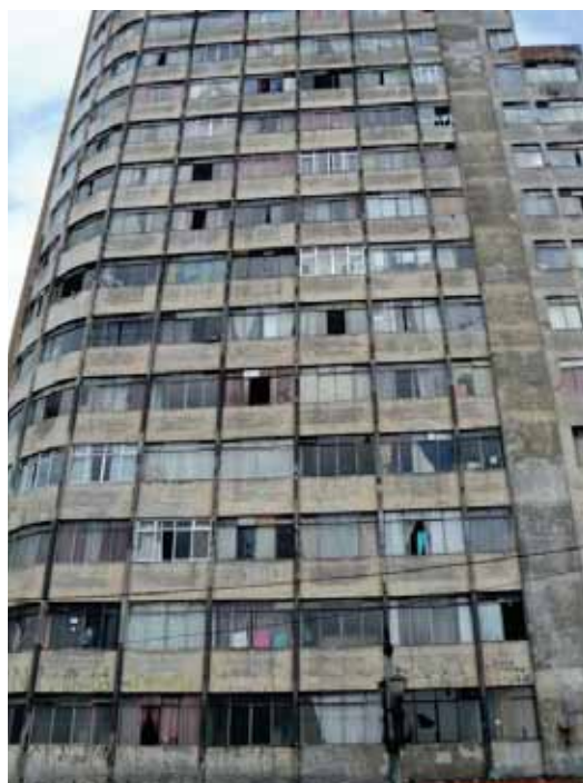
FOTO 10.4.7-2 – EDIFÍCIO RESIDENCIAL EM MAU ESTADO DE CONSERVAÇÃO NA RUA MAUÁ
