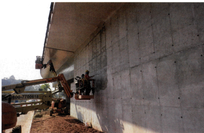
O estucamento da superfície, com duas partes de cimento cinza e uma de cimento branco, veio depois do lixamento, para que não houvesse buracos no concreto e o produto fosse fixado
