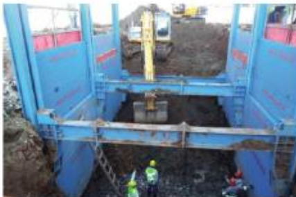
Primeiro módulo na cota do rachão e segundo sendo escavado para baixar trilhos e painéis
