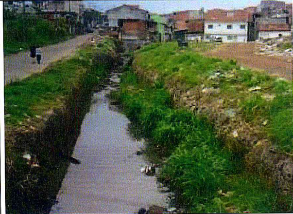
Córrego Bento Henriques : Gabião em deformação
