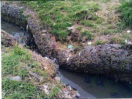
Córrego Bento Henriques : Gabião em deformação
