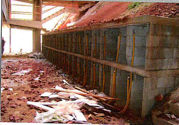
Bloco B: Abrigos de gás
