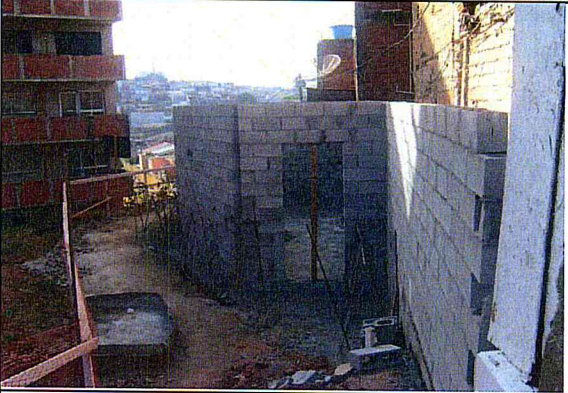
BLOCO A,B e E - CENTRO DE MEDIÇÃO
