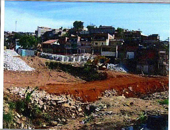
Vista Parcial: Estoque de materiais de drenagem.
