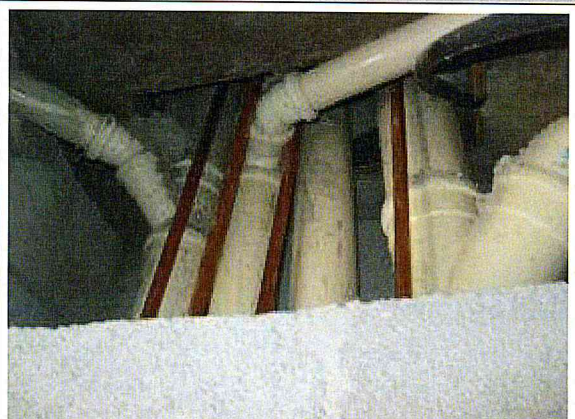
ÁREA DA OBRA. Execução de prumada de esgoto e gás no shaft do apto.
