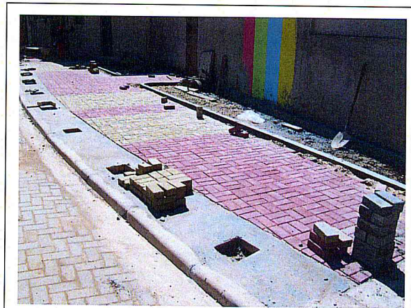
FOTO 2 – Área 157 - Vila Rubi - Rua Projetada 1
