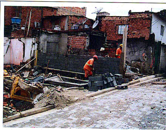
FOTO 3 – Área 157 - Vila Rubi - Rua Projetada 1
