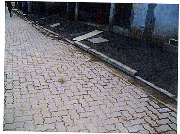
FOTO 2 - Área 172 - Arizona - Rua Carvoeira
