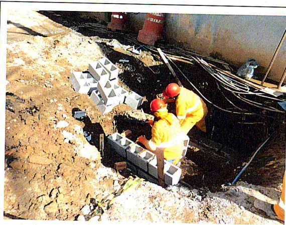
FOTO 3 – Área 172 - Arizona - Rua Carvoeira
