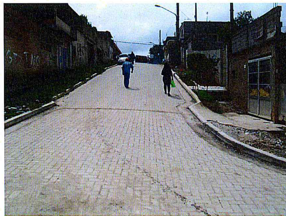
FOTO 2 – Área 231 - Condomínio Vargem Grande - Rua das Figueiras
