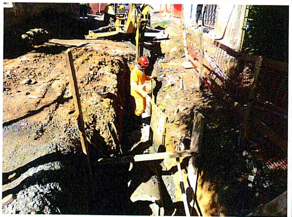
FOTO 4 – Área 172 - Arizona - Rua Carvoeira
