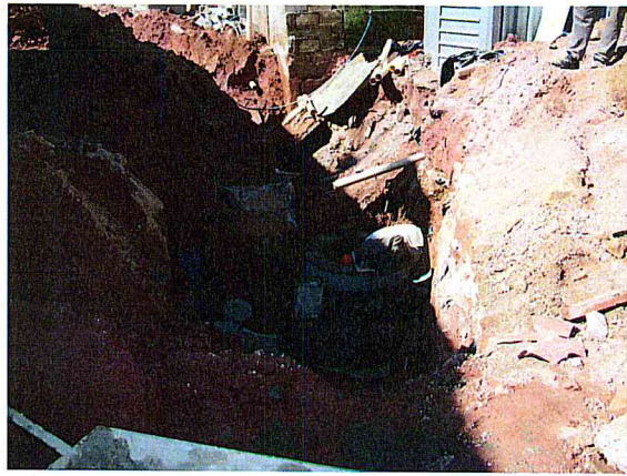
FOTO 1 – Área 157 - Vila Rubi - Rua Projetada 1
