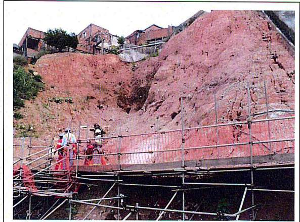
FOTO 2 - Área 174 - Cidade Júlia - Encosta Pedra Sobre Pedra – Setor 2 – Fase 2
