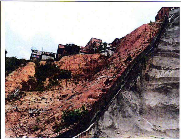
FOTO 1 - Área 174 - Cidade Júlia - Encosta Pedra Sobre Pedra – Setor 2 – Fase 2
