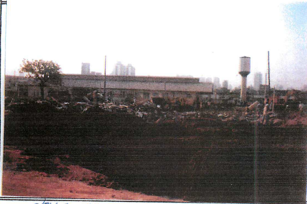
atraso do concreto
