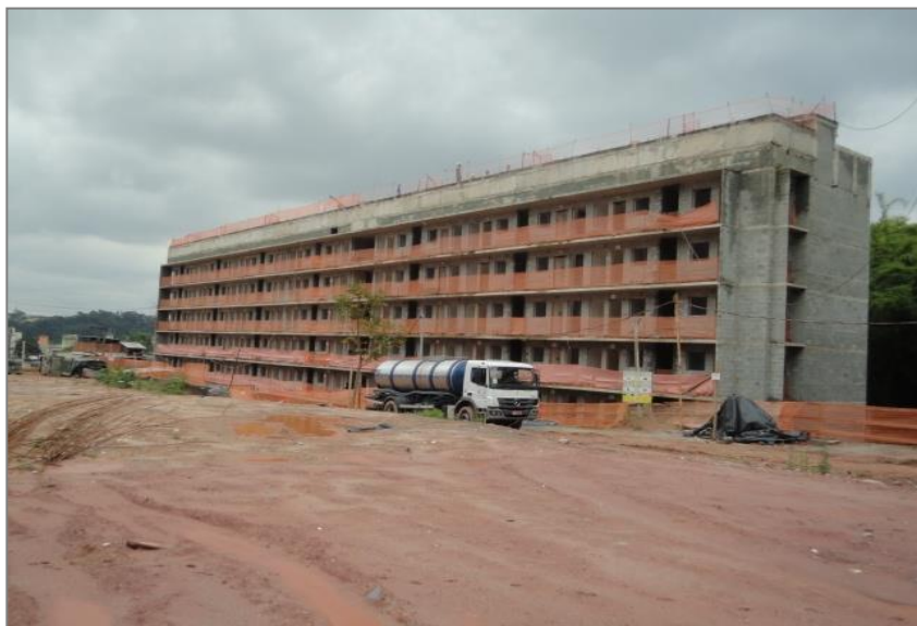
Vielas da Paz: Serviços de acabamentos em execução nos Condomínios B e C.
