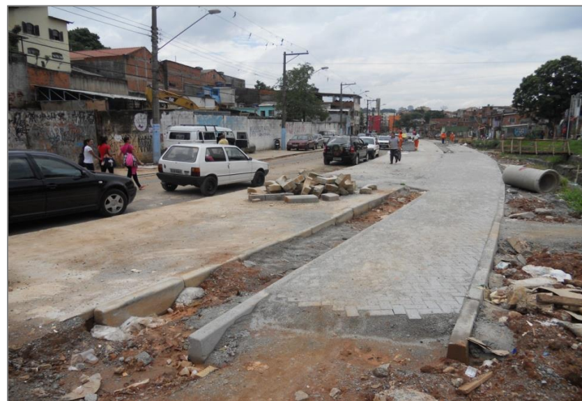
Geral: Em execução serviços de intertravado na calçada na Rua Waldemar Roberto.
