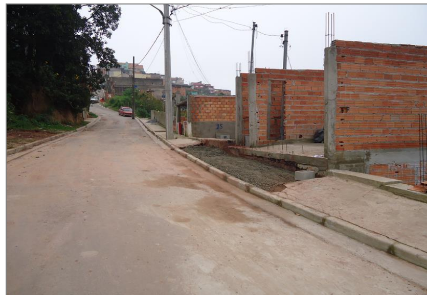
Gerenciamento de Obras de Regularização Fundiária: Parque das Flores – Pavimentação em concreto
