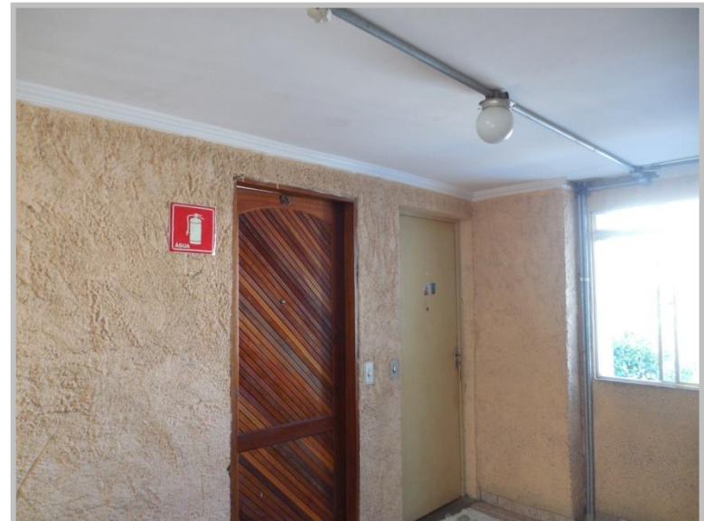
Sinalização vertical de incêndio
