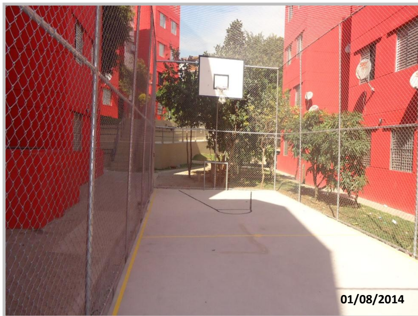
Campo Grande – Fechamento em tela da quadra poliesportiva. Serviços paralisados.
