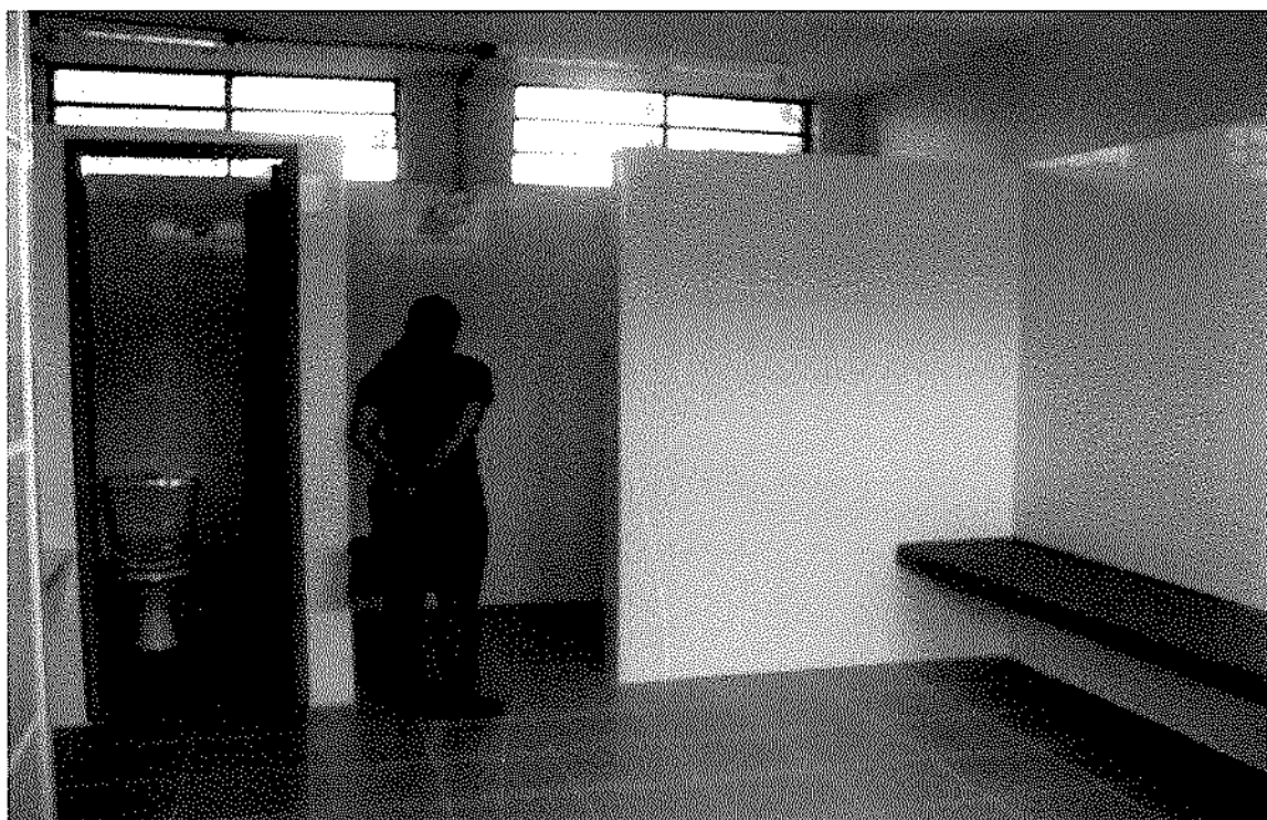
Foto – Bacia sanitária instalada no Vestiário 1
