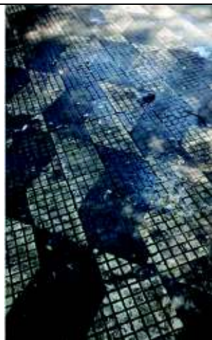
Calçadas das Av. Ipiranga e São João em precário estado de higiene.
