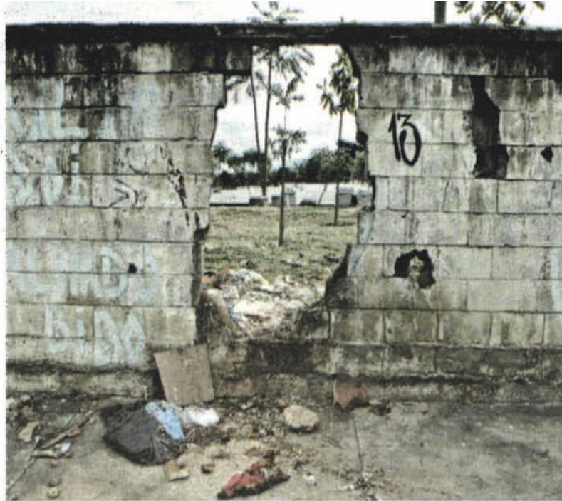
Buraco no muro está aberto há dois anos e serve de passagem para moradores do bairro
