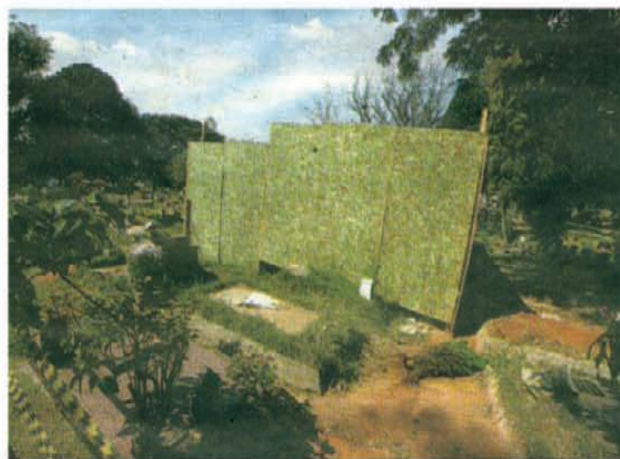
Tapumes e fitas para isolar a área afetada foram as únicas providências adotadas até agora
