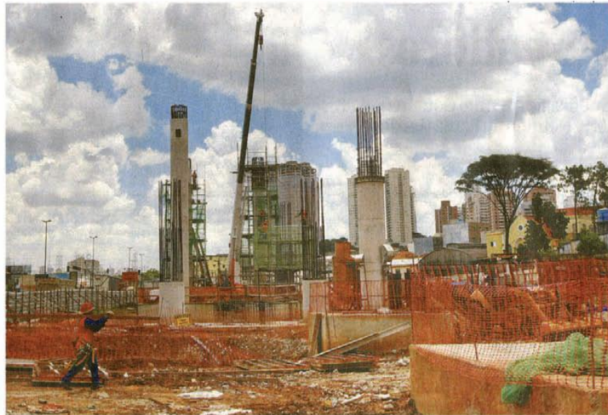
Expresso Tiradentes na av. Prof. Luiz Inácio de Anhaia Melo, na zona leste; para prefeitura, obra é exemplo ambiental
