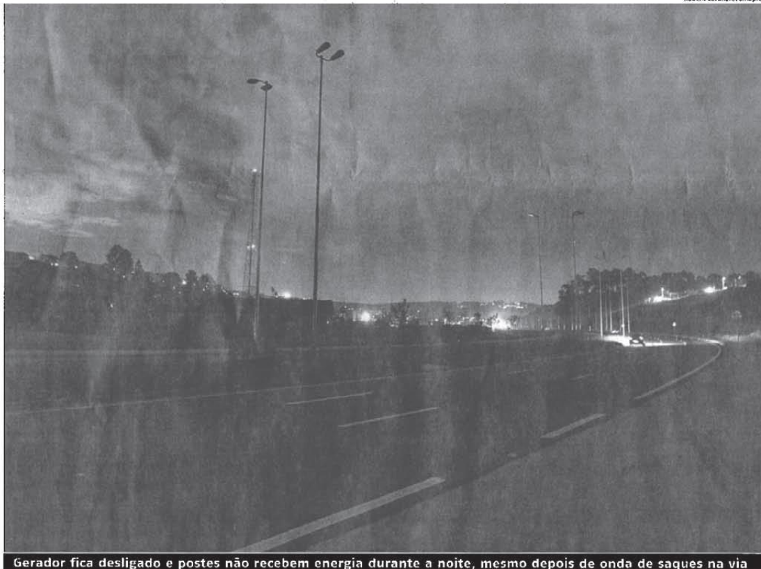
Gerador fica desligado e postes não recebem energia durante a noite, mesmo depois de onda de saques na via
