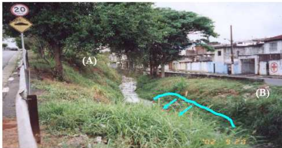
Foto 5.1.1-2: Córrego tributário apresentando solapamento das margens (linha azul).
