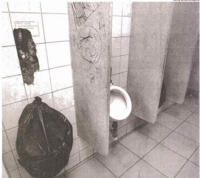
■ Vaso sanitário quebrado em banheiro do velório do Cemitério da Vila Formosa (zona leste de SP); frequentadores do local dizem que há invasões e furtos à noite
