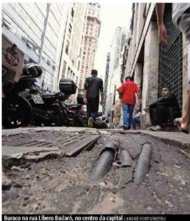
Buraco na rua Libero Badaró, no centro da capital | ANDRÉ PORTO/METRO
