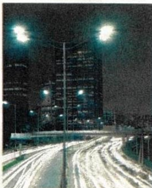
Nova iluminação na Marginal Pinheiros conta com 3.409 luminárias LED distribuídas por 45 quilômetros
