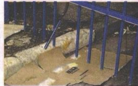
A grade do albergue da Av. Zaki Narchi foi violada, permitindo o acesso de quem quer que seja ao local
