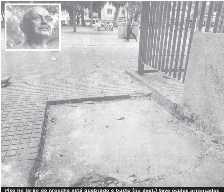
Piso no largo do Arouche está quebrado e busto (no dest.) teve óculos arrancados
