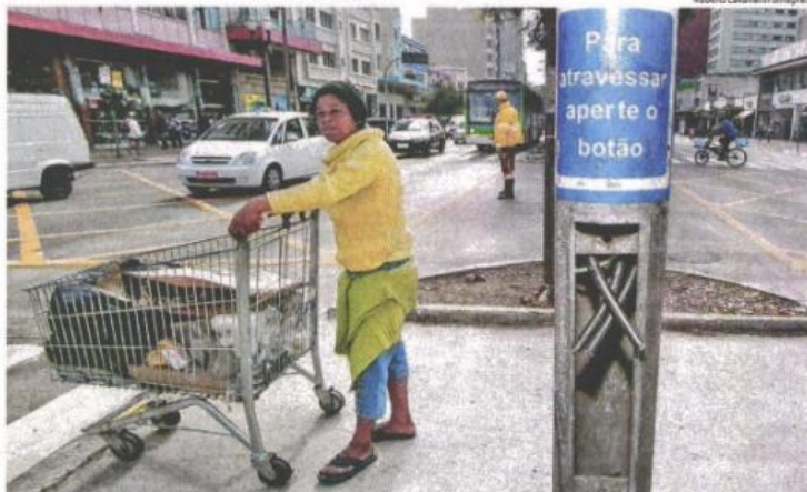
■ Semáforo quebrado após furto de fios na esquina da avenida Rio Branco com a rua dos Gusmões, na Santa Ifigênia (centro); farol é alvo constante de crimes
