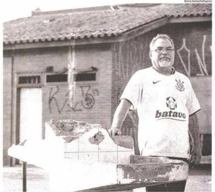
■ O aposentado Carlos José da Silva, 63 anos, frequentador desde a inauguração, ao lado de bebedouro danificado no parque linear Guaratiba, em Guaianases
