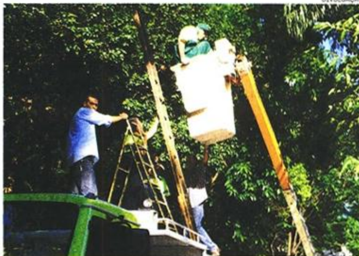
Preso nas alturas. Aparelho teve problema hidráulico
