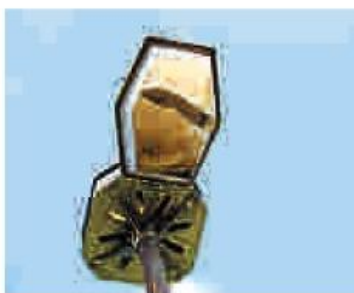
Lâmpadas dos postes estão quebradas
