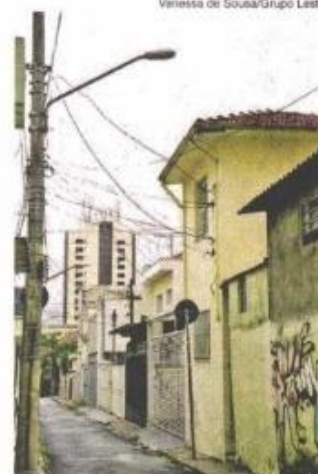
Na Rua Doutor Antonio Luciano Viviane poste tem lâmpada que ascende a apaga constantemente
