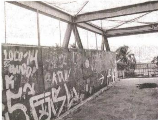
Com alambrado deteriorado, vândalos lançam objetos nas linhas da CPTM e do Metrô
