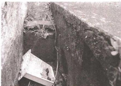
■ Recipiente abandonado no chão acumula água no cemitério da Quarta Parada, na Mooca (zona leste)
