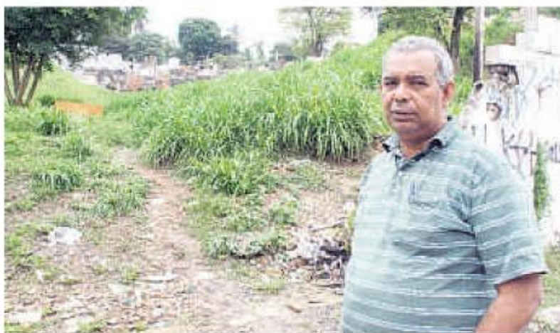
Magalhães mostra muro nos fundos do cemitério que caiu há dois anos e não foi reconstruído
