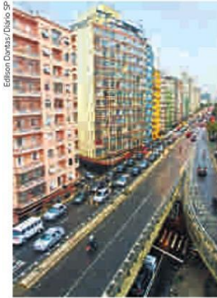
Pista do viaduto está ondulada e com buracos
