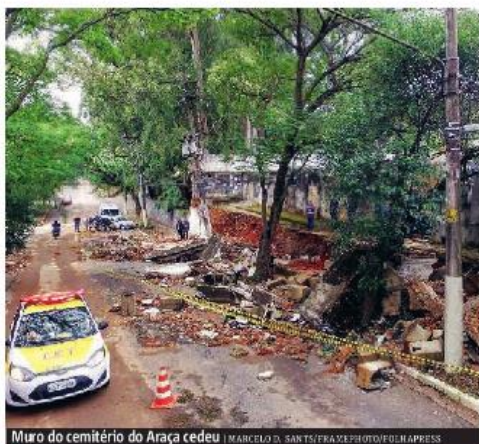
Muro do cemitério do Araçá cedeu | MARCELO D. SANTOS/FRASE/FOTO/FOLHAPRESS
