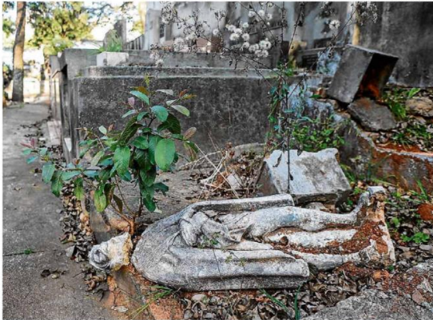
Araçá. Com dezenas de jazigos sem porta e peças quebradas, espaços públicos acabaram se tornando depósito de entulho
