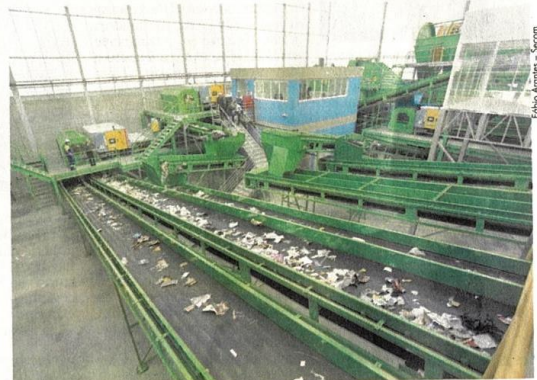
Central de triagem mecanizada de Santo Amaro; maquinário importado da França
