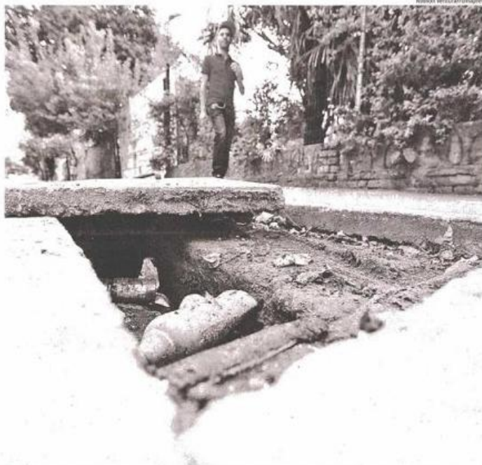
Bueiro com sujeira na esquina das ruas Augusta e Caio Prado, na Consolação (região central de São Paulo); alagamentos são frequentes em dias de chuva
