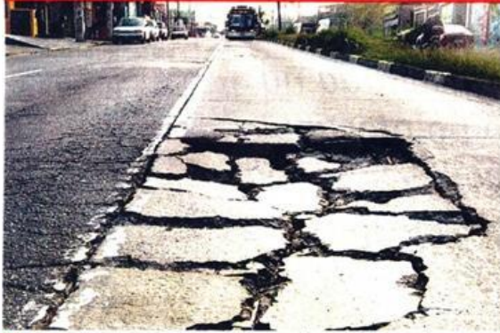
■ Buraco no corredor da av. M'Boi Mirim (zona sul), sentido bairro, na altura do número 5.096, próximo ao terminal Jardim Ângela
