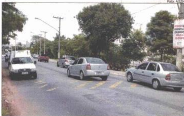
Trecho da Avenida Antônio Maria de Laet, com pista danificada e lombadas mal sinalizadas
