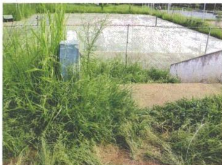
Quadras de tênis de cimento precisam de manutenção, de limpeza e repintura
