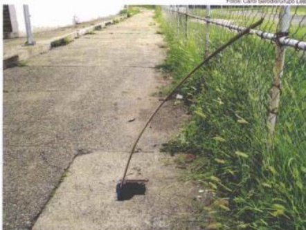
Piso ao lado da pista de atletismo tem buraco sinalizado com pedaço de madeira
