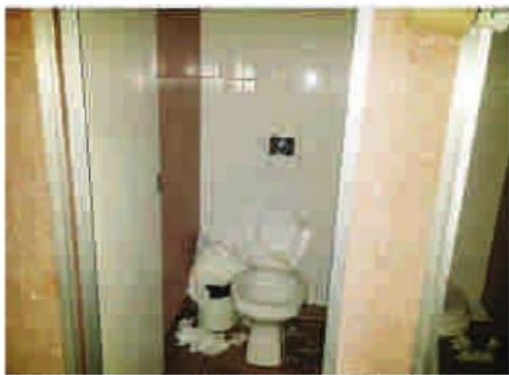
Antes dos banheiros serem interditados, não havia limpeza no local
