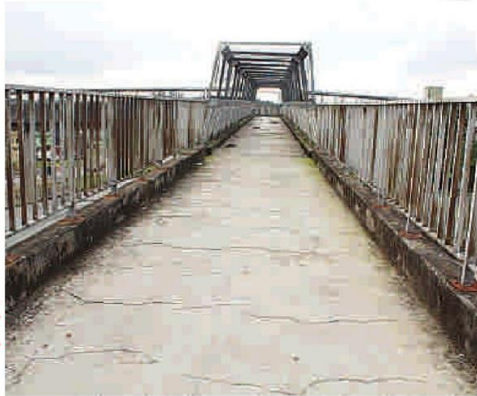
Gradil da passarela na Jacu-Pêssego está toda enferrujada e solta: perigo real para que passa por ali
