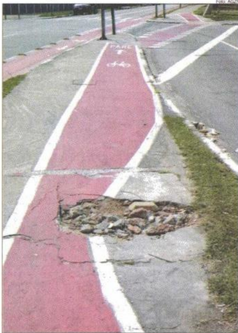
Buraco na ciclovía da Avenida Eng. Caetano Álvares
