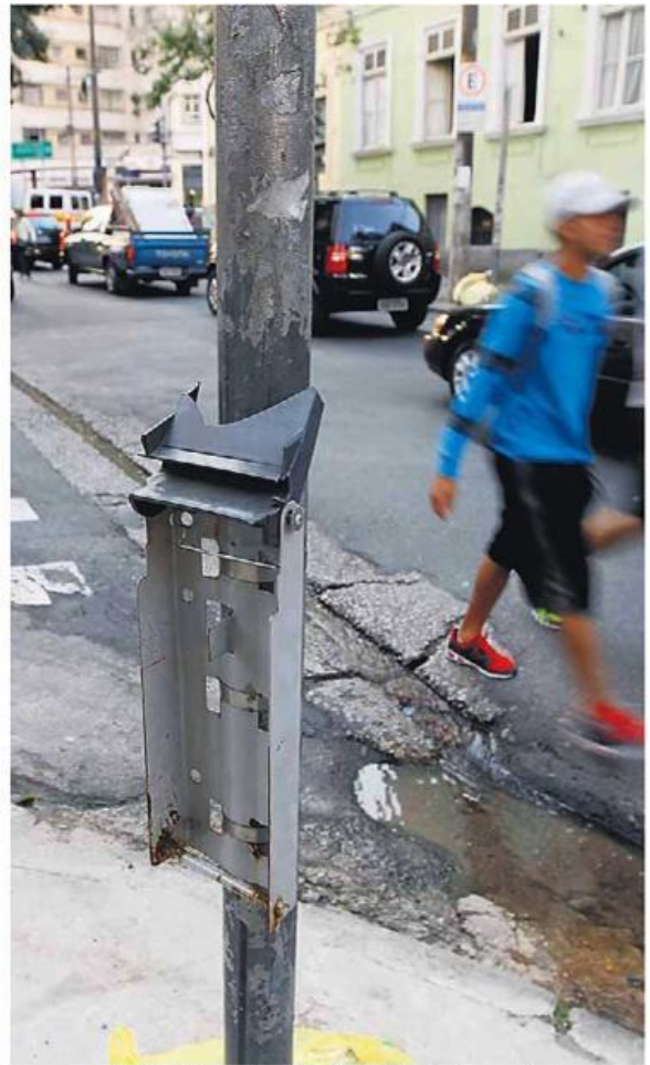
Arrancado. Modelo antigo foi destruído, sobrou só o ferro
