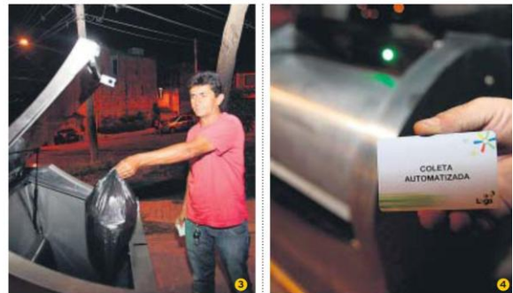
Ao encostar o cartão no sensor (4), a tampa se abre; o lixo é depositado no contêiner subterrâneo (3 e 2); quando estiver cheio, controle remoto aciona levantamento do contêiner que é substituído por outro vazio (1)
