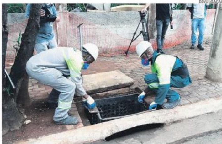
Ecofiltro sendo retirado para limpeza pelos bueristas
