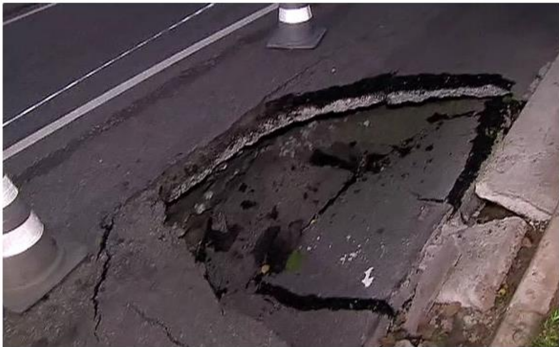
▶ Cratera foi aberta após asfalto ceder em avenida da Vila Olímpia (Foto: Reprodução/TV Globo)
